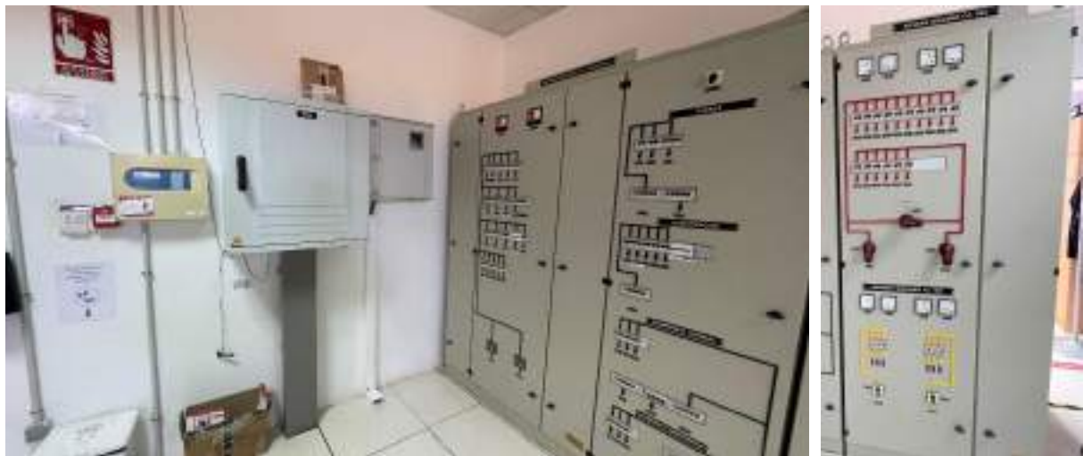
Figura 6 – Sala de control SET Mingorrubio Armario mural de contadores y armario de servicios auxiliares CA y CC
