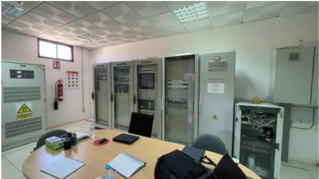
Figura 4 – Sala de control SET Mingorrubio Armarios de protección, control y comunicaciones
