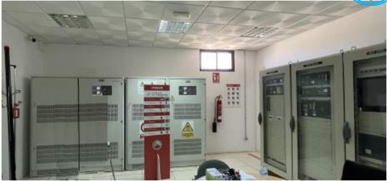
Figura 5 – Sala de control SET Mingorrubio Armarios de rectificadores y baterías, y protección
