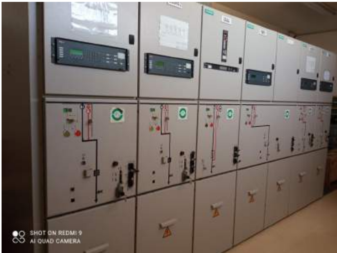
Figura 2 – Sala de celdas SET Mingorrubio. Módulo de celdas 20 kV existente.
