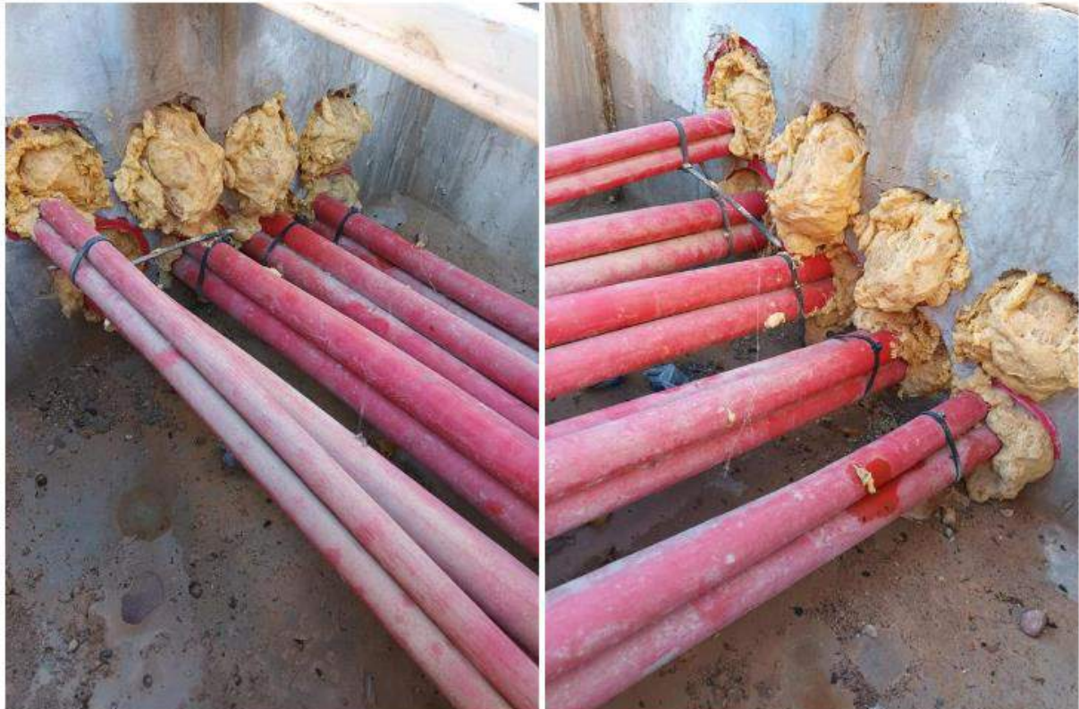
Figura 8 – Arqueta de paso entre celdas de MT y transformador de potencia.
