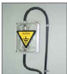
Caja de Seccionamiento de Servicio
