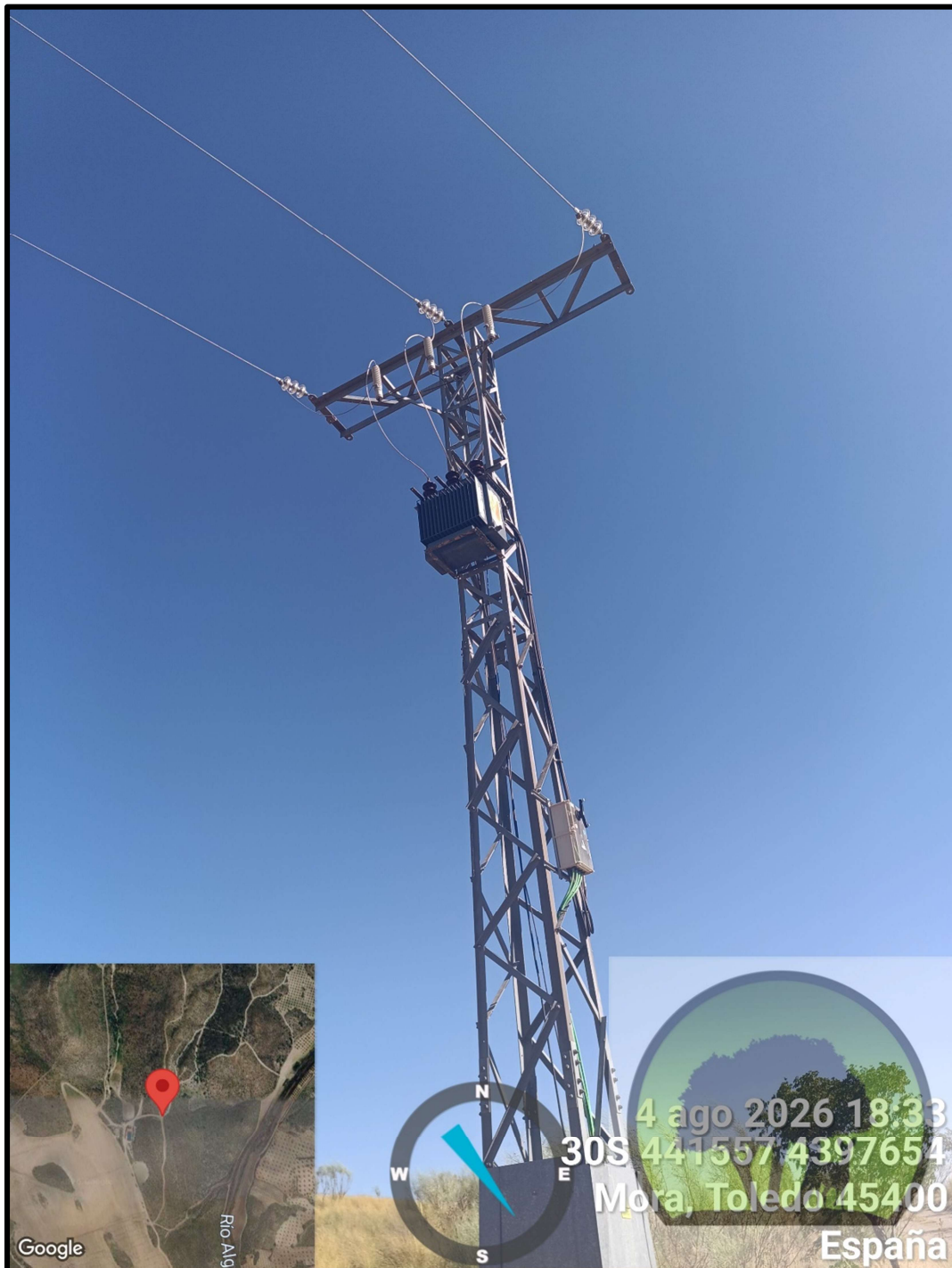
Foto 2: Apoyo transformador, media tensión.
