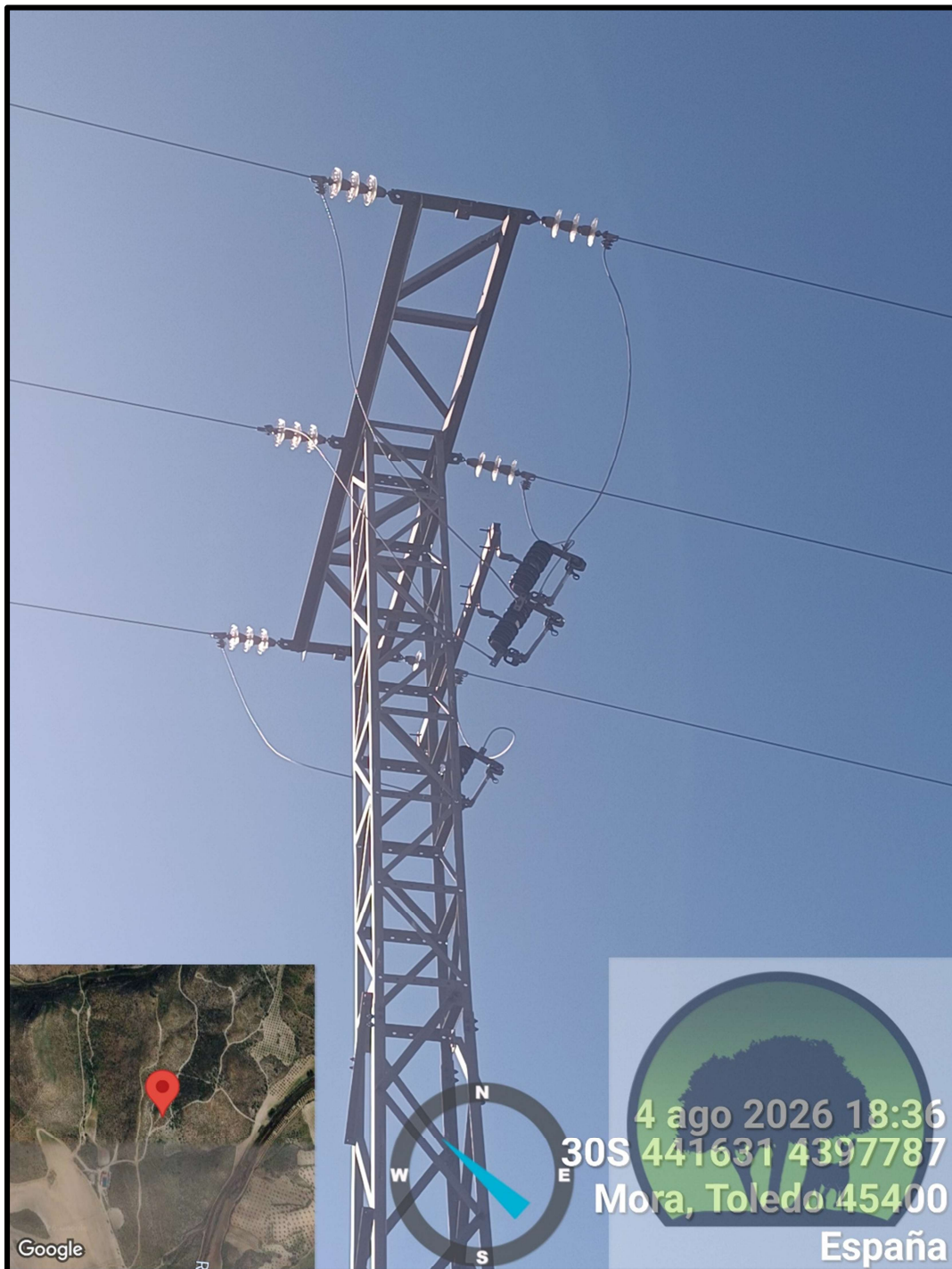
Foto 3: Apoyo fusibles, media tensión.
